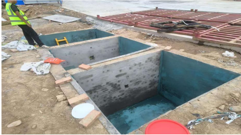
图 5.1-1 施工冲洗废水处理设施
