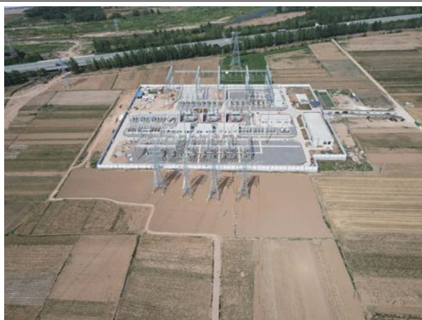
项目终点 330kv 汇集站
