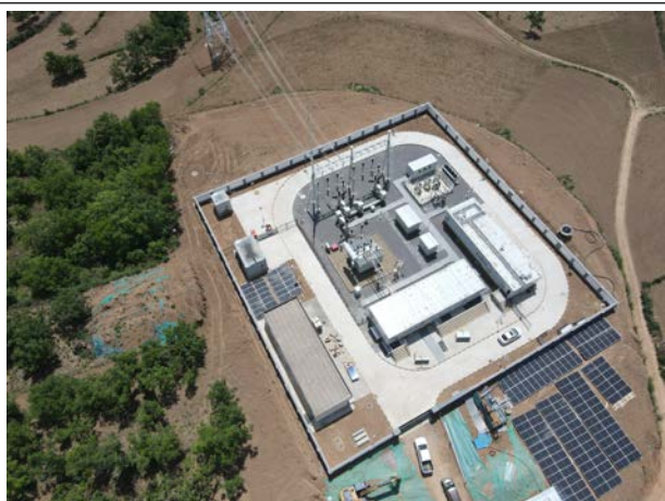
项目起点光伏升压站
